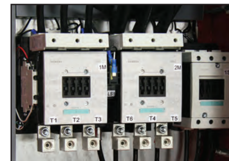
• Conjunto de contactores estrella triángulo
