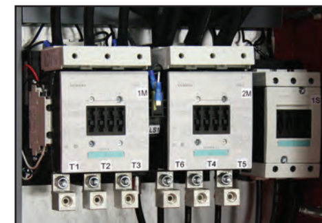
• Conjunto de contactores estrella triángulo
